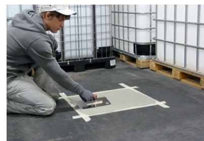
PCI Nanocret R4 PCC in einer Produktionshalle zum Lagern und Abfüllen chemischer Produkte
